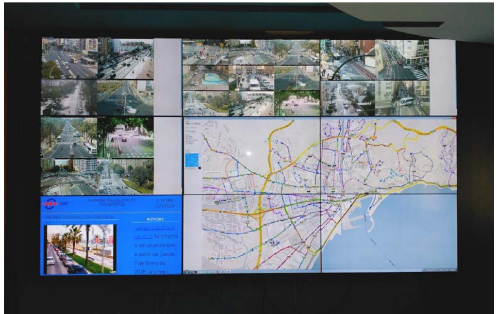
El video wall de 3x3 en el centro de control de la EMT
